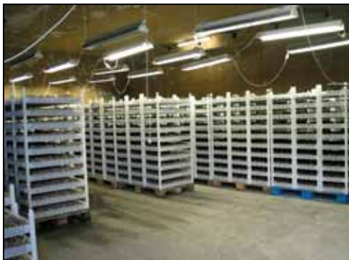
Lysarmatur i taket
